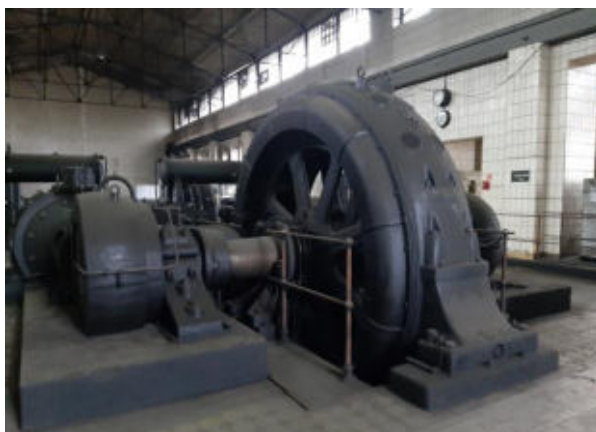
Fotografia 21. Wnętrze budynku siłowni energetycznej z urządzeniami
